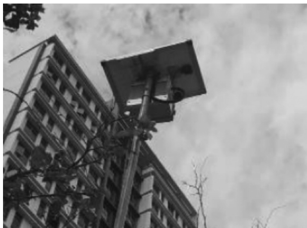
一個項目工地使用的太陽能電池板
